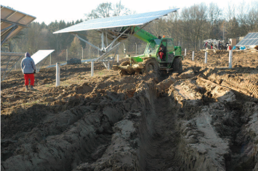
Abb. 5: Zerstörte Fläche während des Baus einer PV-Anlage im westlichen Landkreis Straubing-Bogen
